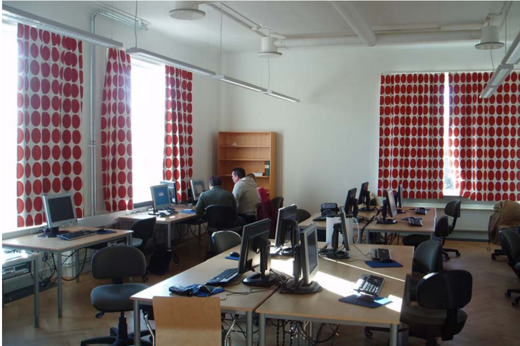
Bild 3 Installerad motoriserade tilluftsdon av märket IDCC, från LindinVent AB.
