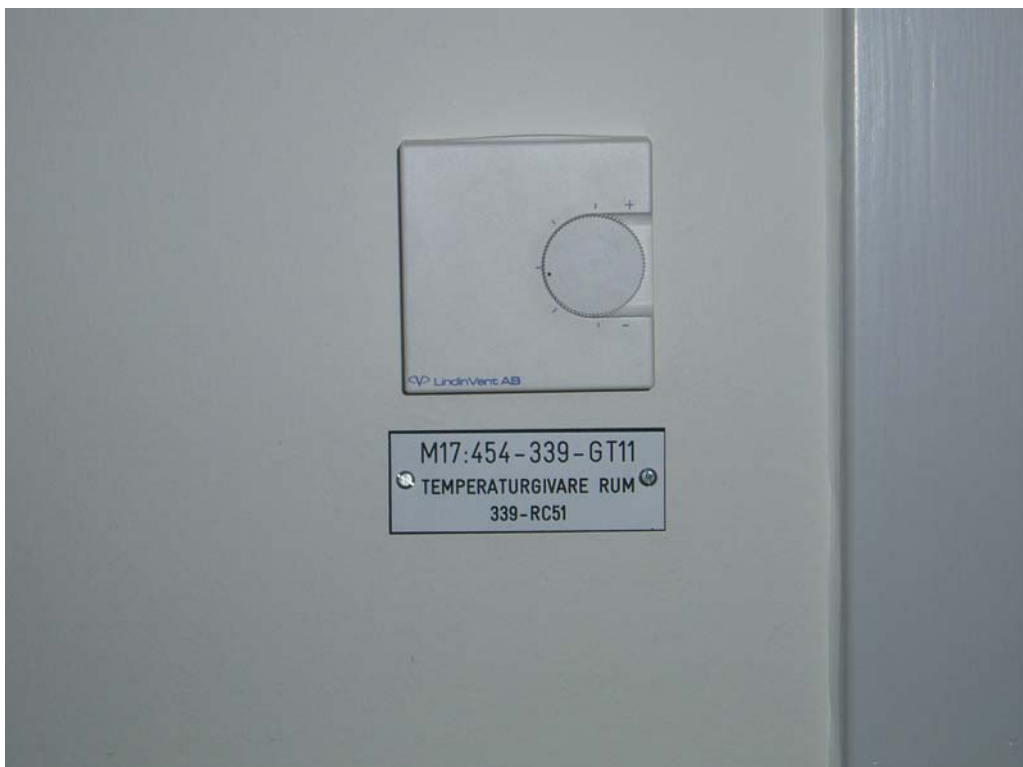
Bild 6 Styr- och reglerenhet (temperatur) för system IDCC. i kontorsutrymme.
