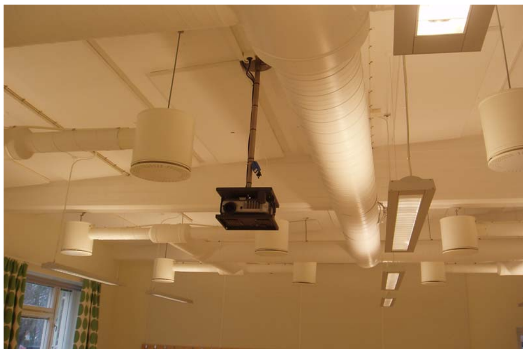
Bild 1 Installerad motoriserade tilluftsdon av märket e.r.i.c. från STIFAB FAREX AB.
